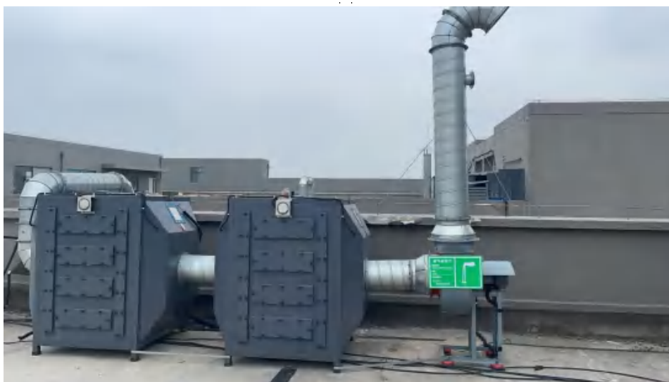
图 4-2 注塑废气处理设施图片
