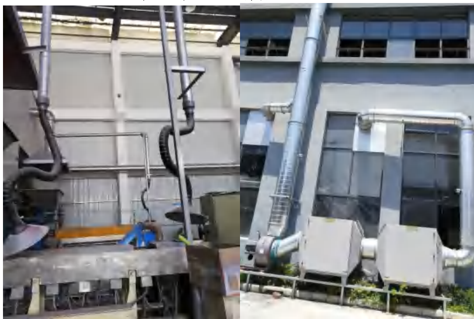
图 4-3 本项目挤出废气治理设施
