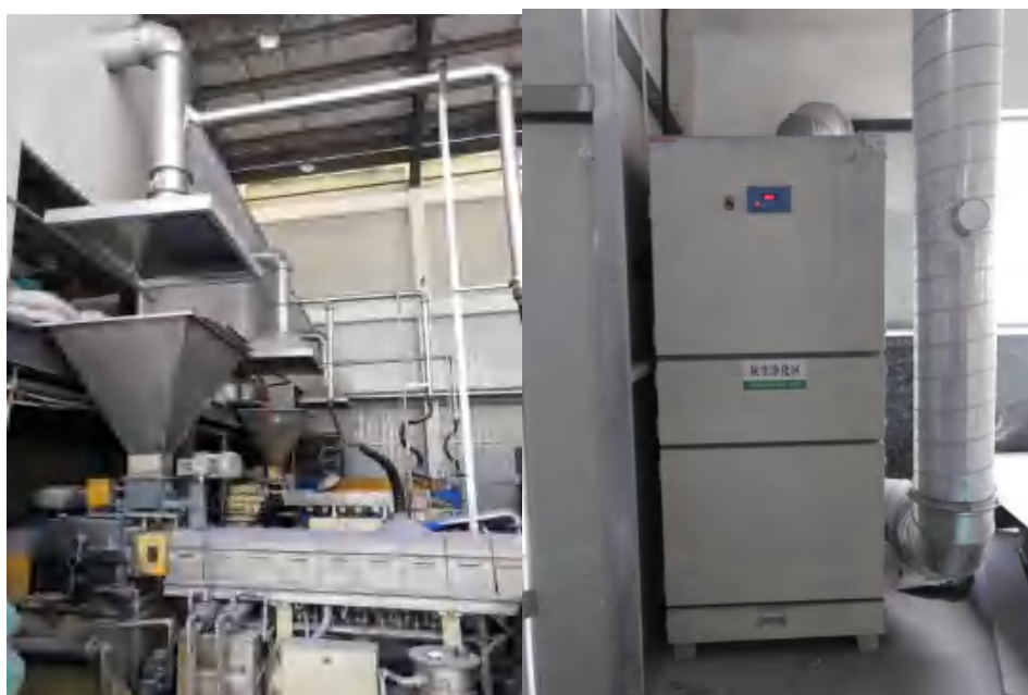
图 4-2 本项目投料粉尘治理设施
