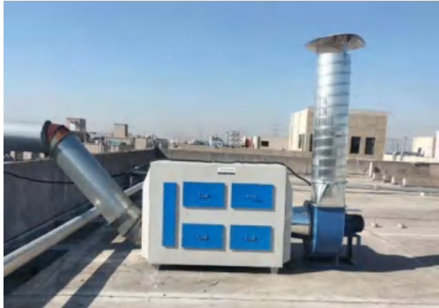
图 4-2 废气治理设施图
