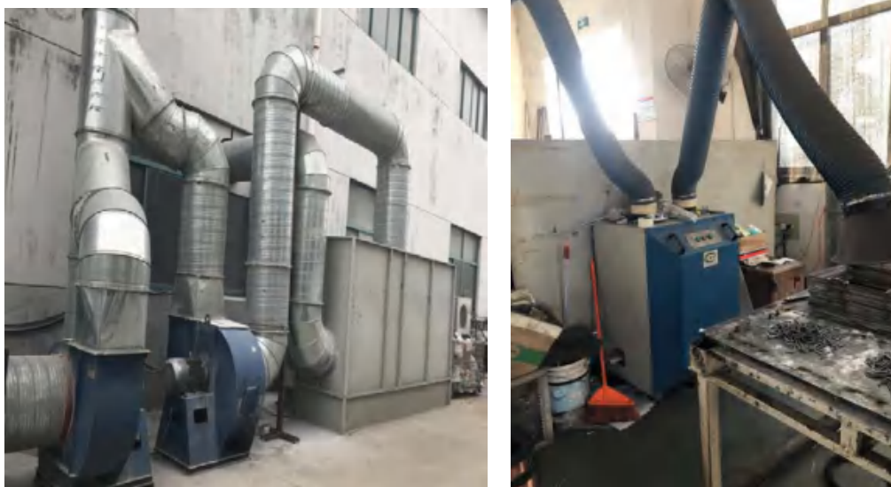
图 4-4 本项目废气治理设施图片
