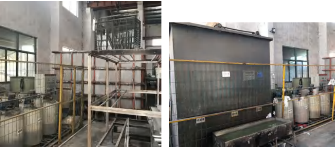
图 4-2 废水处理设施图
